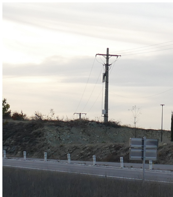
< Photo poteaux électriques sur le site - décembre 2017
