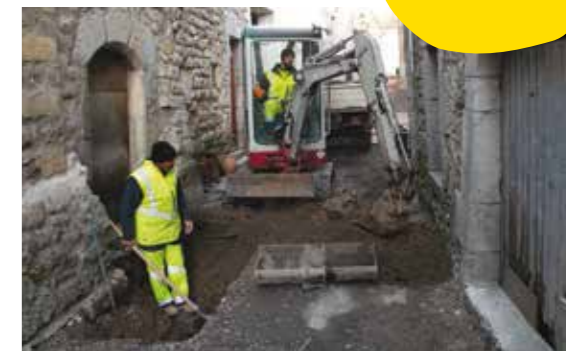
Plus de 1 360 branchements au réseau d'assainissement qui demande un entretien régulier.
